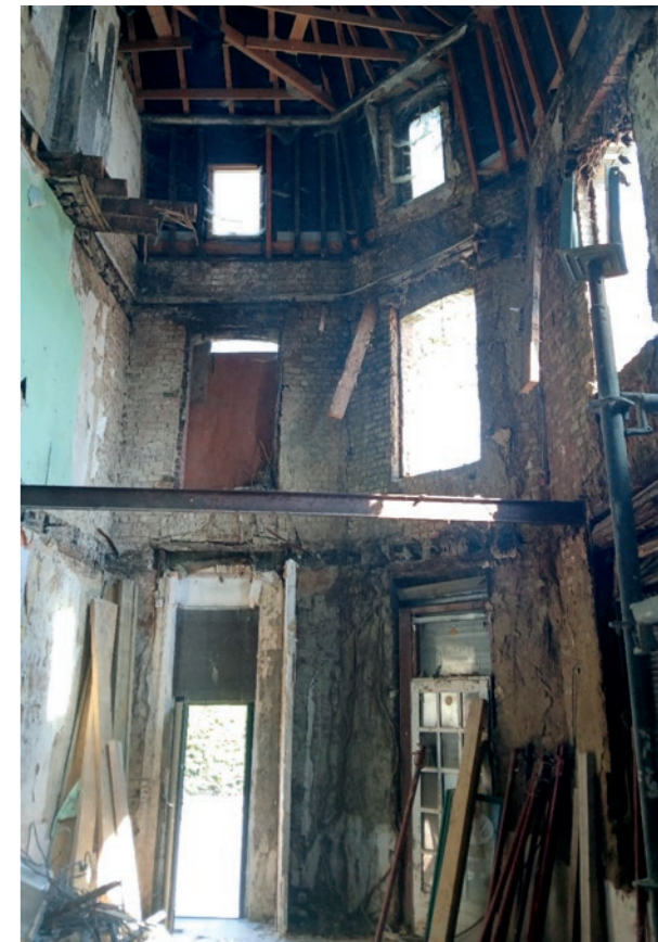
Vue d'un logement vacant dégradé ©La fabrique des quartiers
