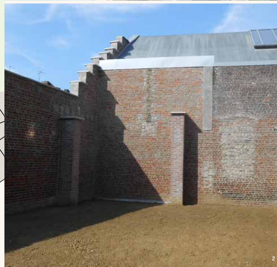
1. Vue de la cour Veuve Florin avant les travaux de déconstruction 2. Vue de la cour Veuve Florin après les travaux de déconstruction
