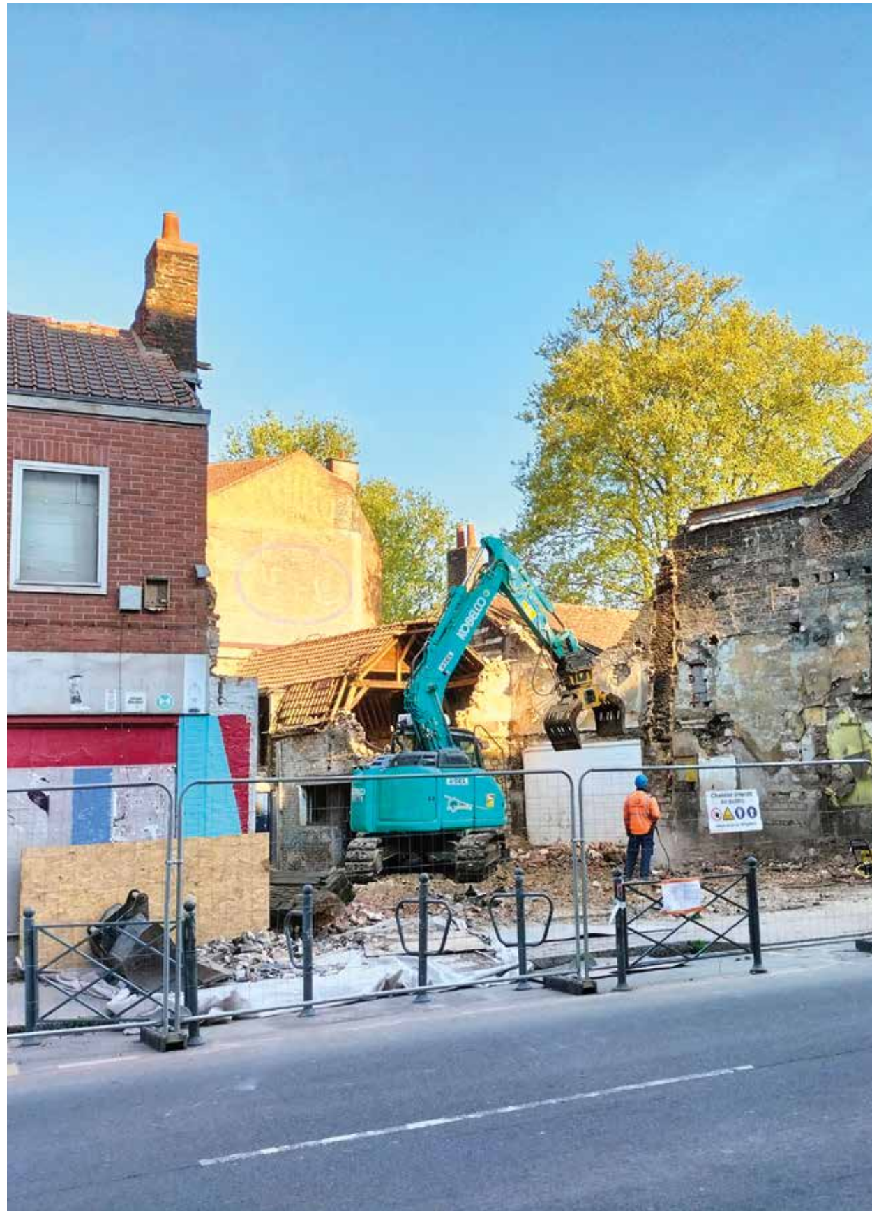
Déconstruction menée par Oria promotion pour la réalisation d'une dizaine de logements et en rdc le nouveau bureau de poste du quartier Moulins Lille quartiers anciens / sam.banchet.
