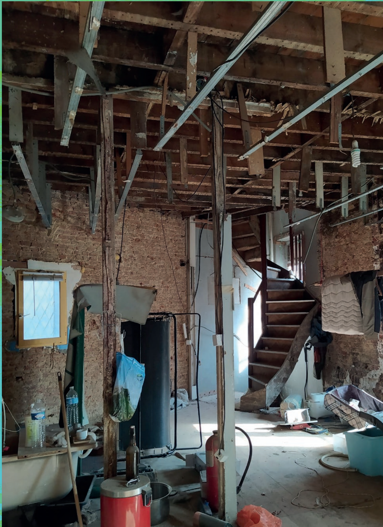
Copropriété dégradée diagnostiquée à Lille par La fabrique des quartiers, NPNRU LQA
