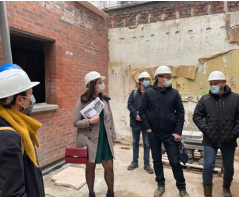
Visite de chantier avec Madame le Maire, Tourcoing - Crédit : La fabrique des quartiers
